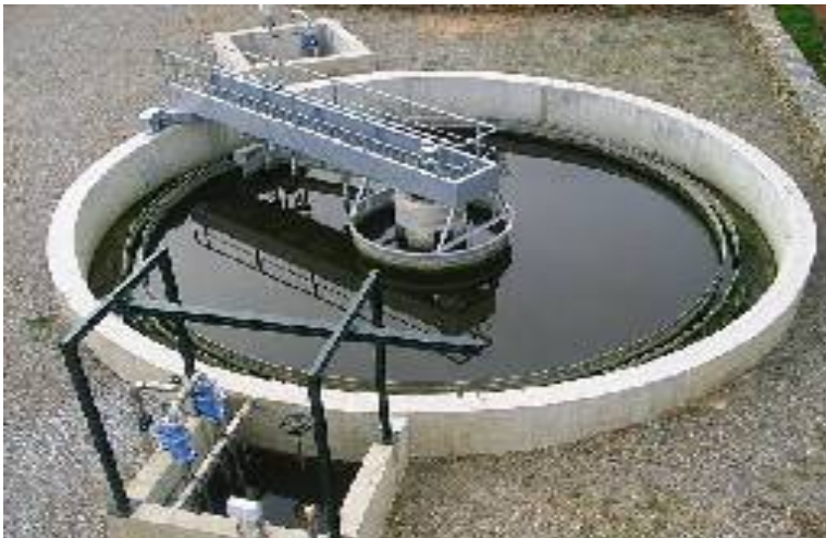
Decantador: 8,8 m diámetro
