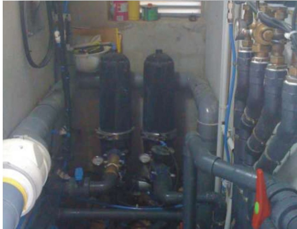
Fila de deslodos con limpieza automática
