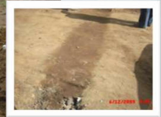
Protección de tubería con piedras y pavimento posible
